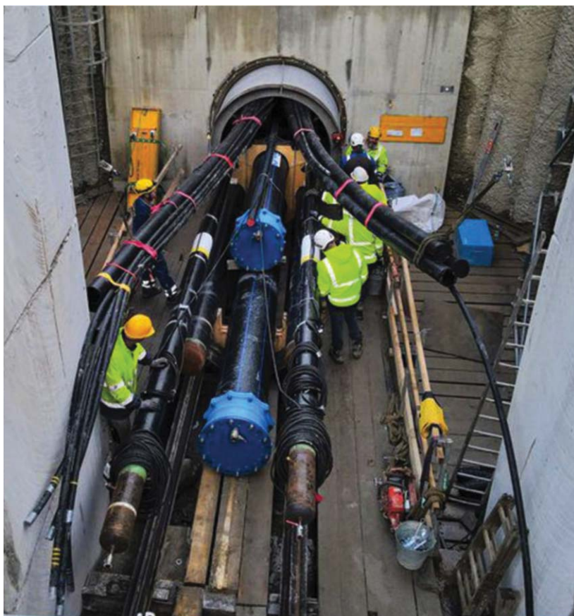
1. ábra. Az Ausztriában a Duna alatt átvezetett alagútban elhelyezett víz, gáz, melegvíz csövek és kábel-vezetékek. A vízcsövek és a kábel védőcsövek műanyagból készültek.
